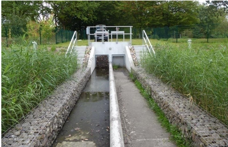
Mittige Verteilerrinne zur alternierenden Beschickung zweier Filterflächen
