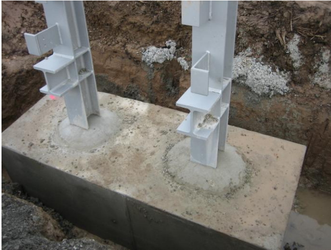
Einbau von 2 Pfosten in einem gemeinsamen Fundament; Pfahl mittig unter dem Fundamentbalken.
